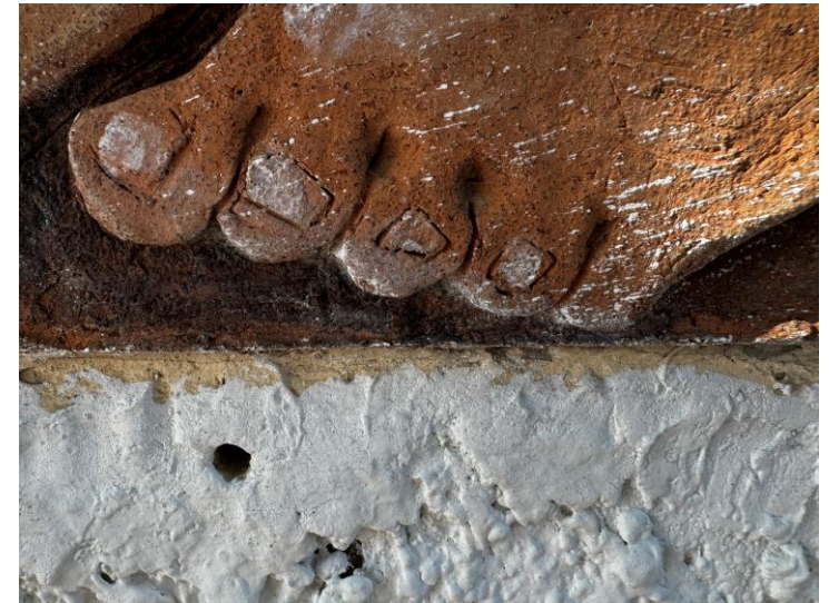
כתמי צבע ופס צבע ישן סביב התבליט
