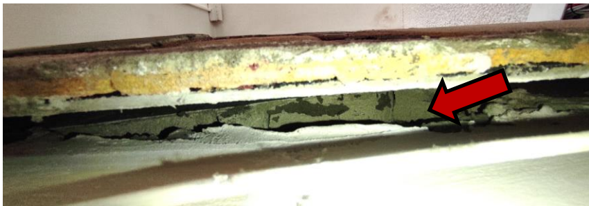
ב' התנתקות מהקיר – תקריב (ניתן לראות חור בקיר מתחת. ניכר כי הלוח התחתון פורק כולו בזמן הרכבת תשתיות תקשורת ולאחר מכן הוברג מחדש בזווית שונה מהמקור – כפי שמפורט בהמשך פרק זה)
